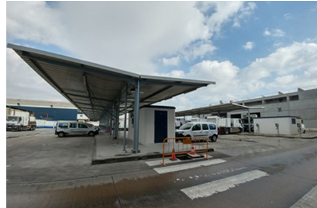
Instalación inteligente de recarga de vehículos eléctricos, Parque de FCC en Barcelona.
